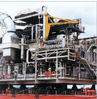
Off-Shore-Anlage für Ölplattform, Norwegen
